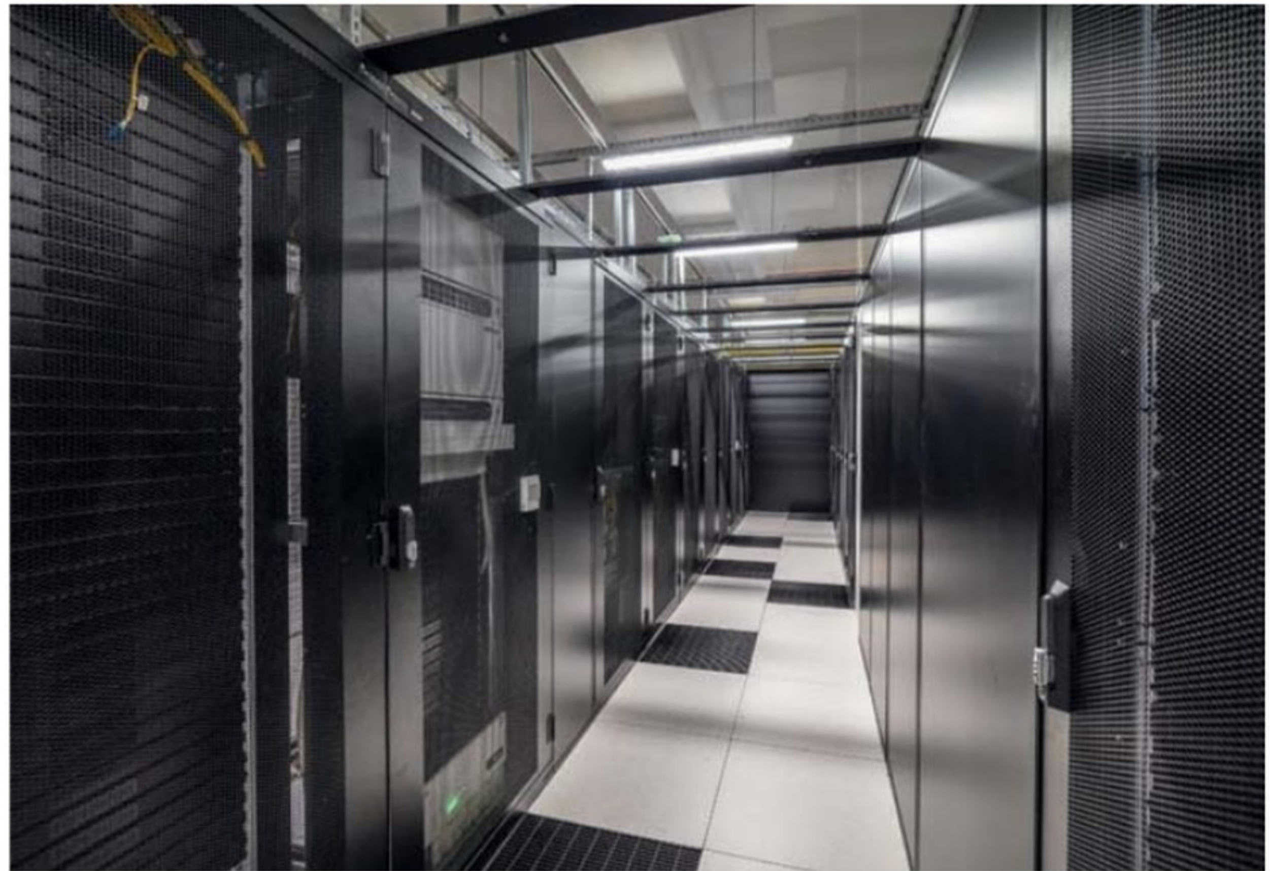
Une allée froide dans le centre de données Interxion de Marseille exploité par Oracle Cloud.
